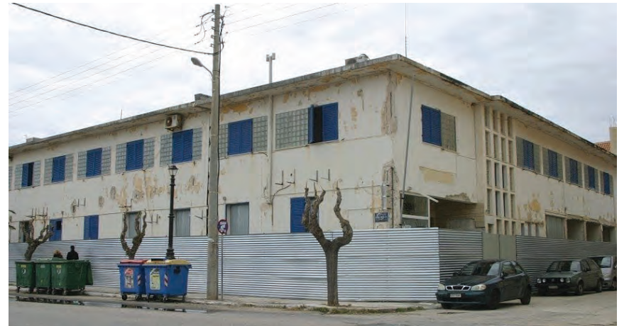
Το παλιό κτήριο της αστυνομίας στο Αργοστόλι. Το γεγονός ότι βρίσκεται σε σημείο όπου το βλέπουν όλοι οι τουρίστες που επισκέπτονται την πόλη άφησε ασυγκίνητους τους αρμόδιους για 15-20 χρόνια! Τώρα λένε ορισμένες πληροφορίες ότι θα βρεθεί λύση. (ΦΩΤΟ INKEFALONIA.GR).
