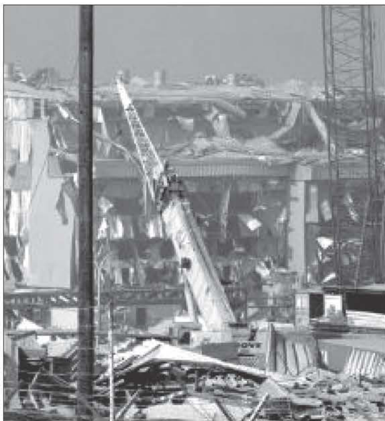
Ο Ηλεκτροπαραγωγός Σταθμός της ΑΗΚ στο Βασιλικό καταστράφηκε κατά τη φονική έκρηξη στο Μαρί.
